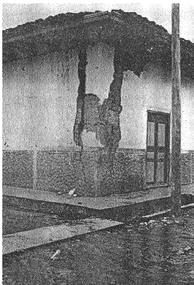
Foto 13 Vivienda de tapial, con agrietamiento en esquina
