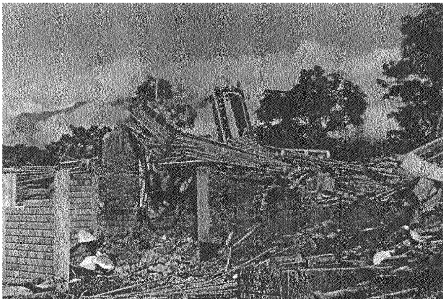
Foto 24 Soritor: Iglesia colapsada totalmente
