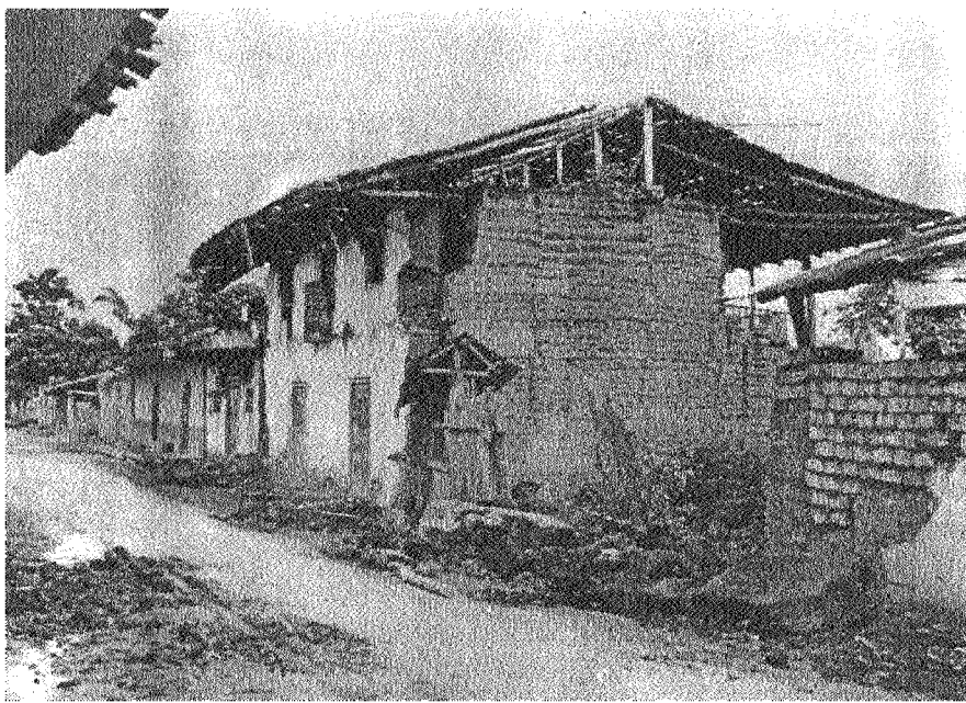
Foto 14 Vivienda de tapial con desprendimiento de la esquina y fractura de entpiso.
