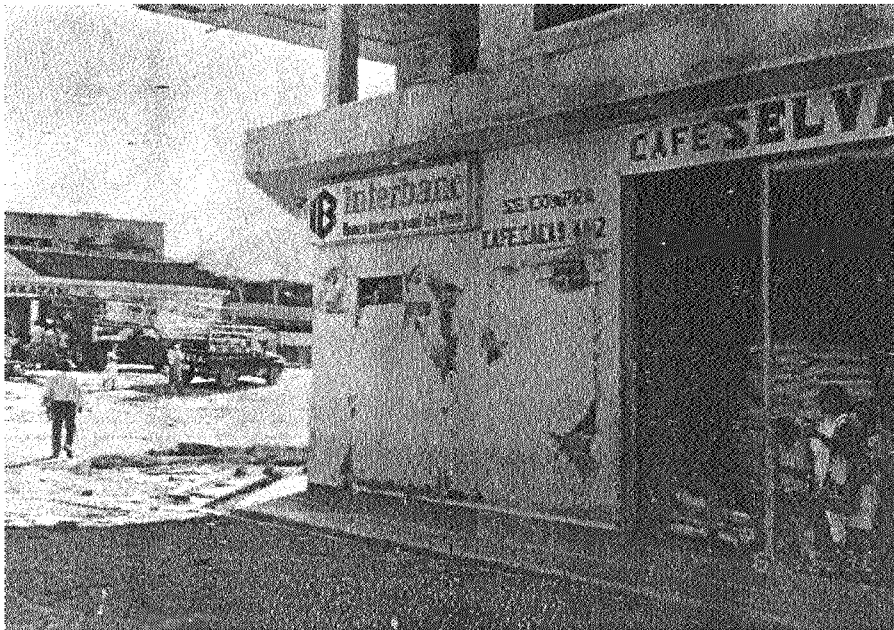
Foto 19 Daños en edificio de concreto armado (Nueva Cajamarca).
