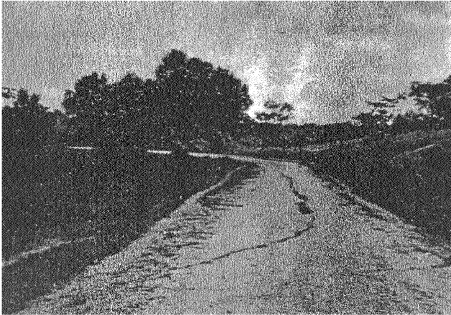
Foto 33 Red vial. grietas en diferentes puntos.
