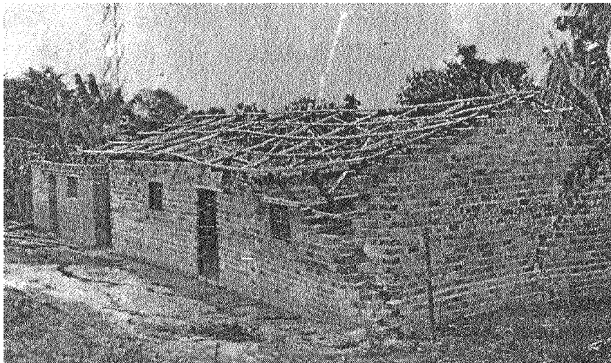
Foto 16 Vivienda de ladrillos sin confinar, en zona de licuación (Azungue- Moyobamba)
